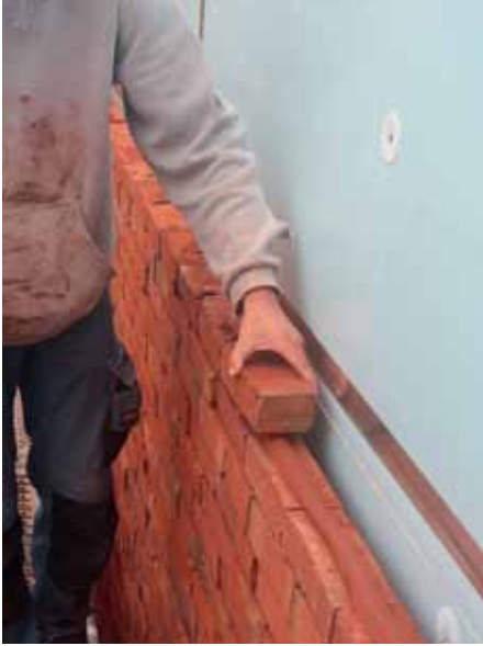
De bouwvakkers van Bouwbedrijf Degraeve leggen de stenen mooi met de rechte achterkant tegen de koord. Alleen hangt die koord hier aan de 'binnenkant' van de spouw en niet aan de buitenkant.
